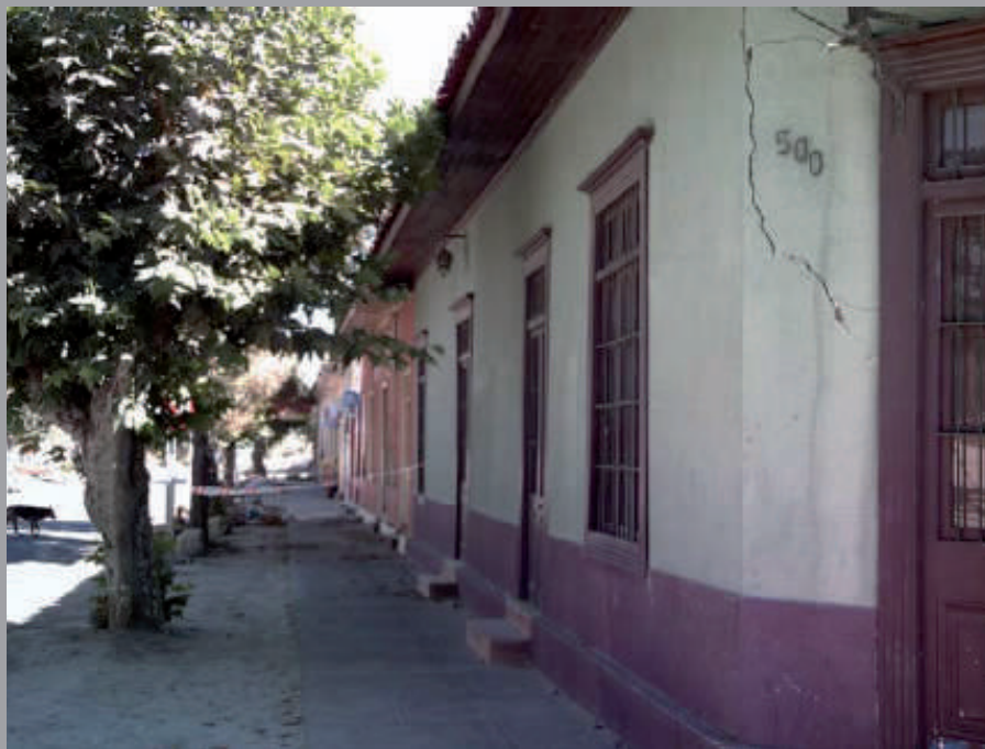
Fachada continua con grietas.
